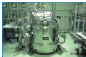
<バイオマスプラスチック製造設備>
