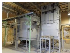
<Li-ion電池リサイクル設備>
